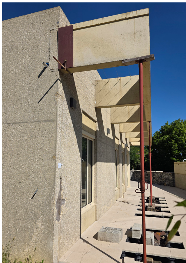
Nouvelle mairie : Exemple de désordres observés : fissures
