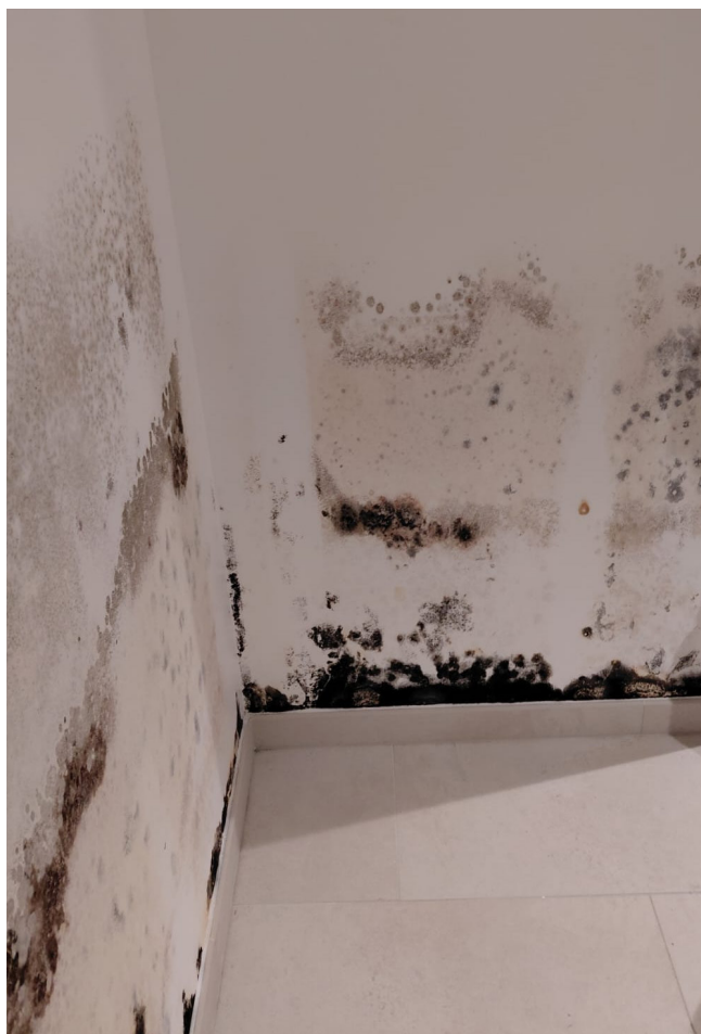
Nouvelle mairie : Exemple de désordres observés : traces d'humidité sur les murs
